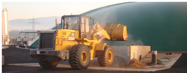
Figur 8: Indfødning af faste biomasser i Sauter-anlæg
